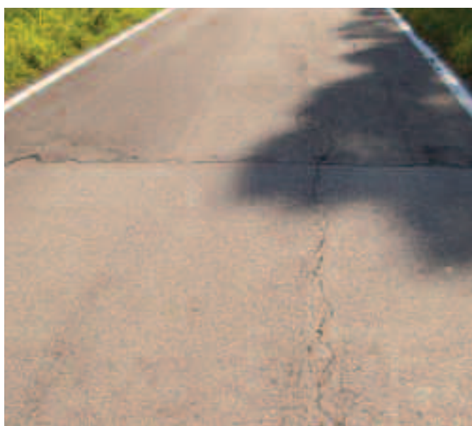
Foto 4.5 Tratto finale dell'intervento della pavimentazione non rinforzata. Nell'immagine, in corrispondenza del ciglio, è possibile notare che sono già stati eseguiti più interventi di riparazione sovrapposti (se ne possono identificare 3) del manto stradale. Il fenomeno della fessurazione riflessa consiste infatti nella propagazione delle fessurazioni della vecchia pavimentazione attraverso il nuovo strato superficiale dopo la riparazione.
