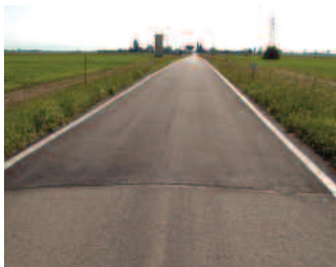
Foto 3.10 Ampliamento del rifacimento del manto stradale già rilevato nella precedente ispezione (confrontare con la foto 3.8).
