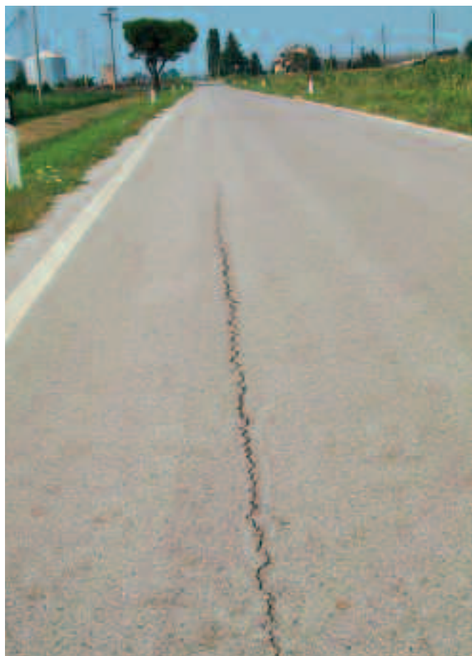
Foto 3.5 Particolare della fessura longitudinale che rispetto al sopralluogo precedente non presenta particolari aggravii (apertura 0,7 ÷ 2,0 cm) (confrontare con la foto 3.1).
