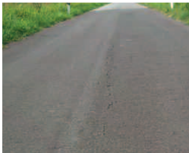
Foto 4.3 Fessurazione diffusa sul manto stradale rifatto.
