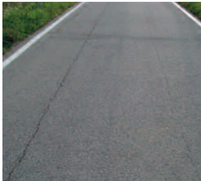
Foto 3.9 Testimonianza delle lesioni longitudinali in prossimità della zona di carico presenti nella pavimentazione stradale con evidenti cedimenti differenziali.
