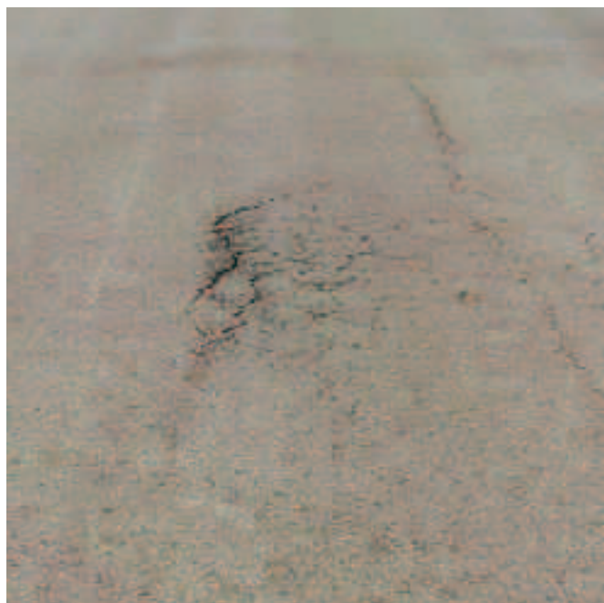
Foto 3.6 Fessurazione diffusa a "pelle di coccodrillo" indice di una situazione fortemente danneggiata e, confrontata con la foto 3.3, mette in evidenza una espansione e aggravamento del dissesto così monitorato.
