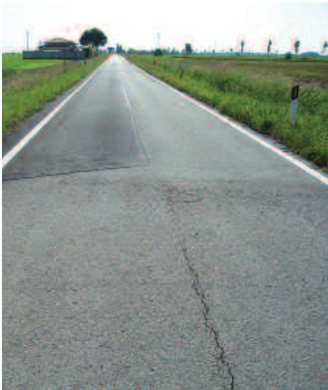
Foto 2.10 Ulteriore rifacimento del manto stradale provocato dall'aggravio della fessurazione lungo la corsia stradale (da confrontare con la foto 2.5)
