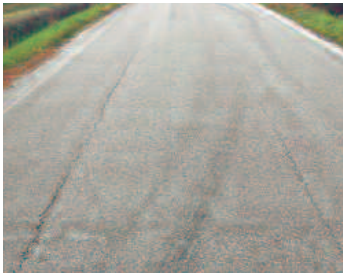
Foto 3.7 Fessurazione con conseguenti ormaie a causa della scarsa portanza del terreno sottostante non assorbita dal rinforzo in geogriglia.
