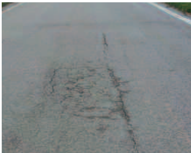
Foto 3.3 Dalle foto precedenti è evidente il danneggiamento della pavimentazione stradale. Il propagarsi delle fessure dà alla stessa un aspetto a "pelle di coccodrillo" cioè caratterizzato da una lesione principale longitudinale da cui si dipartono delle altre fessure radiali che si congiungono e si approfondiscono creando, nel tempo, un forte degrado della carreggiata.
