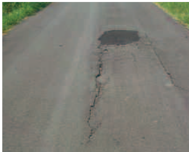
Foto 4.2 Immagine che, confrontata con la foto 4.1, mette in evidenza l'aggravio del dissesto rilevato sul tratto di pavimentazione ripristinata.
