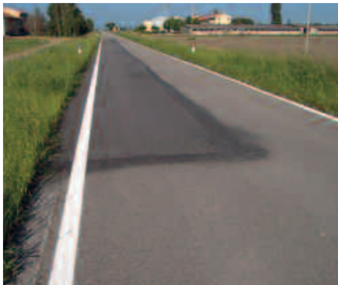
Foto 4.4 Ulteriore strato di rifacimento del manto stradale in un tratto di pavimentazione non rinforzata.
