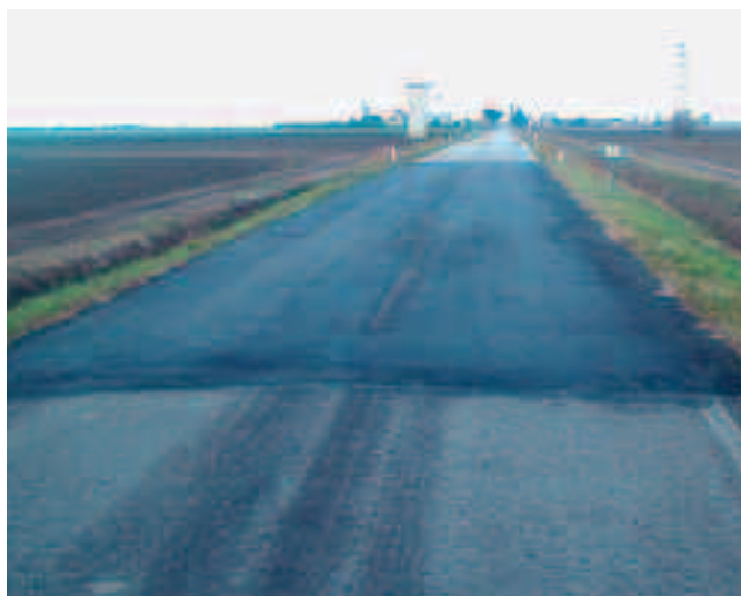
Foto 3.8 Rifacimento di un tratto del manto stradale a causa dell'elevata entità del dissesto tale da superare la soglia di funzionalità della pavimentazione stradale (da confrontare con la foto 3.2).
