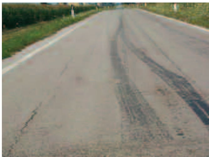
Foto 3.4 Testimonianza delle lesioni longitudinali presenti nella pavimentazione stradale con evidenti cedimenti differenziali.
