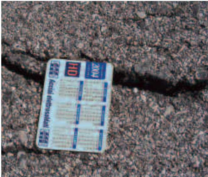
Foto 2.9 Particolare dell'ampiezza di fessura.
