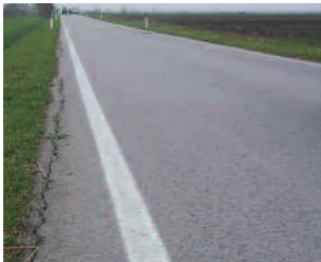
Foto 1.3 Si sono notate in diversi punti lungo il percorso appartenenti a tutti i tratti sperimentali delle lesioni longitudinali in corrispondenza dei bordi della carreggiata. Tale difetto è facilmente superabile tramite un allargamento del pannello che dovrà prolungarsi per tutta la larghezza della pavimentazione stradale.
