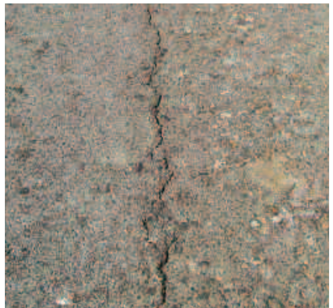
Foto 2.4 Particolare della lesione sull'asse stradale (apertura \approx 1,0 \div 1,5 cm) con evidenti diramazioni laterali e fenomeni di subsidenza cioè si può individuare un cedimento del terreno e quindi del manto stradale proprio in corrispondenza della lesione longitudinale.
