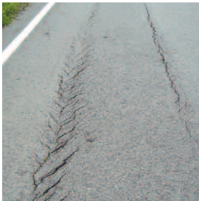
Foto 2.8 Peggioramento del dissesto provocato dalla grave lesione nel centro di una corsia, già rilevata nel sopralluogo precedente, approfondimento dell'ormaiamento e allargamento della fessura.
