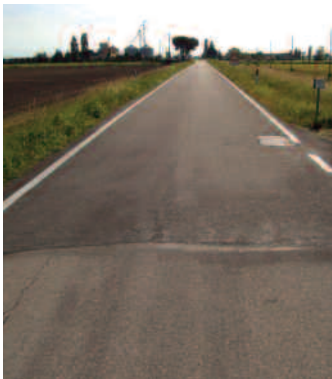
Foto 3.11 Si evidenzia la presenza di un nuovo tratto sottoposto ad un intervento manutentivo realizzato a causa del degrado (fessurazione e ormaimento) diffuso sull'intera carreggiata (confrontare con la foto 3.5).
