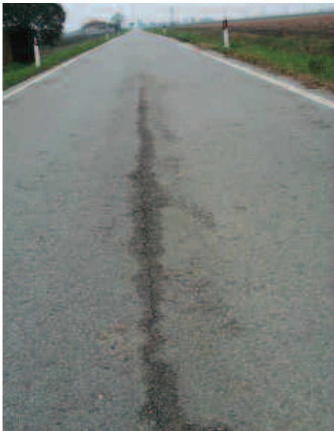
Foto 2.2 Dalle foto riportate si può notare lo stato di degrado della pavimentazione stradale, caratterizzata da lesioni longitudinali piuttosto profonde in cui si è verificato il fenomeno di risalita di acqua per capillarità.
