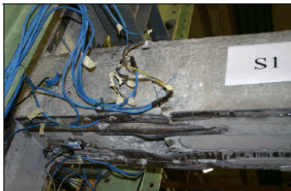
Figura 27. Espulsione del calcestruzzo e taglio di un angolare
