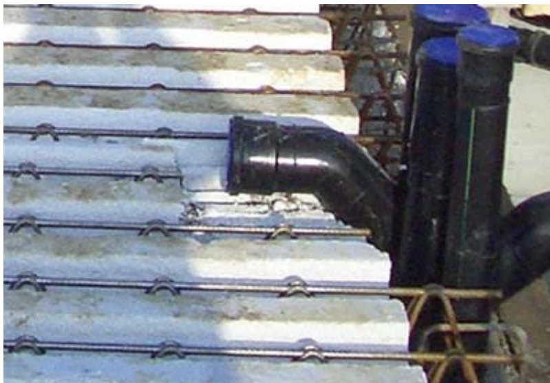
Figura 6. Traliccio interrotto per motivi impiantistici
